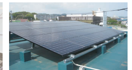
太陽光パネル
